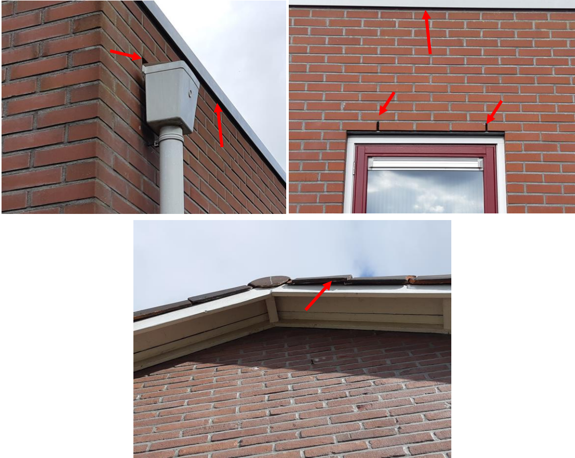
Figuur 3.1 Potentiële invliegopeningen (rode pijlen) die toegang geven tot het dak of de spouwmuur. Linksboven: ruimte bij regenpijp en daktrim. Rechtsboven: open stootvoegen en daktrim. Onder: ruimte bij kantpannen. Bron foto's: Ecogroen
